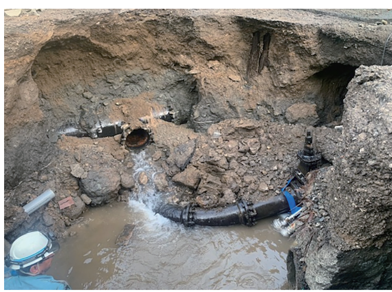
老朽管がこわれて漏水事故がおき、水びたしになった様子
