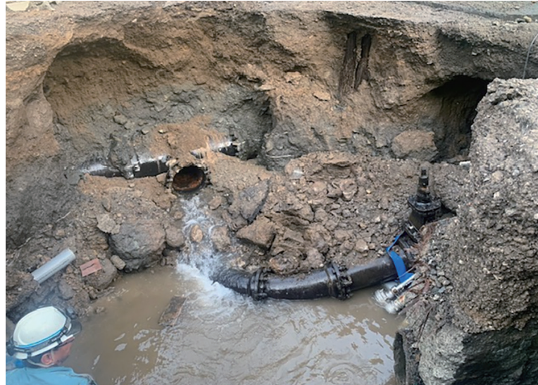
ろうきゅうかんがこわれて漏れ水事故がおき、水びたしになった様子
