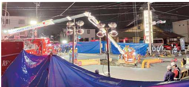
八潮市の道路陥没事故
